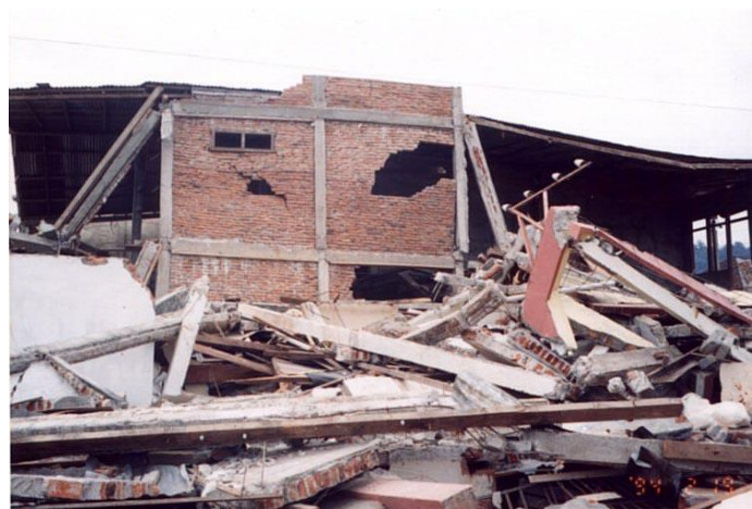
Gambar 8b Struktur rangka beton bertulang yg dikombinasikan dengan dinding pasangan bata. Foto kiri dan kanan, bangunan runtuh disebabkan oleh: (1) dinding bata tidak diperkuat dg tulangan penahan beban tegak lurus bidang ( face load ), (2) penyelesaian detail join komponen beton yang tidak sesuai dengan ketentuan bangunan tahan gempa (lihat keterangan Gambar 5d), (3) mutu pengerjaan yang rendah. Gempa Liwa 16-2-1994.
