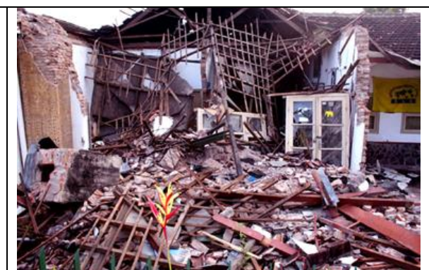
Gambar 5f Dinding pasangan bata polos (P/M) berfungsi sebagai bearing wall , mendukung kuda-kuda atap, runtuh total, diikuti jatuhnya rangka atap. Kota Yogya.
