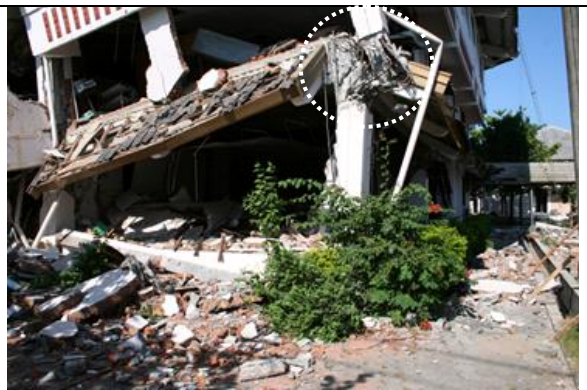
Gambar 14b Rusak geser pada BCJ ( beam-column-joint ), akibat kurangnya sengkang penahan geser.
