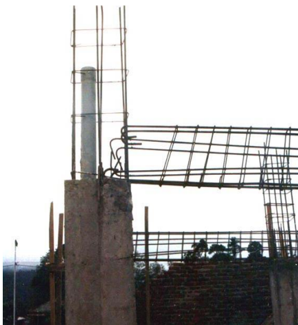
Gambar 8a Contoh detail baja-tulangan struktur rangka beton yang salah, yang menyebabkan keruntuhan bangunan pada Gambar 5e. Ujung batang tulangan balok tidak terjangkar ke dalam kolom atau balok lainnya. Gempa Liwa Palembang 16-2-1994.
