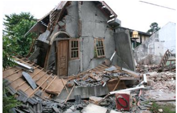
Gambar 5b Rusak berat (runtuh total) bangunan rumah yang struktur vertikalnya terbuat dari dinding pasangan bata polos, tanpa komponen perkuatan. Akibat Gempa Yogya 27-5-2006.
