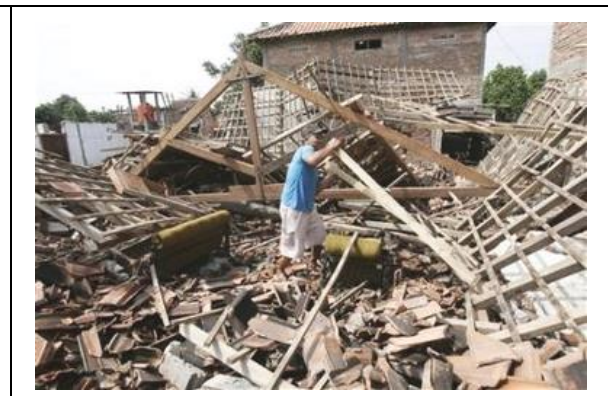
Gambar 5d Walaupun rangka atap (kuda-kuda) masih utuh, tetapi runtuhnya dinding-bata pemikul atap, menyebabkan runtuh total seluruh bangunan.
