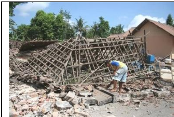
Gambar 5c Roboh total bangunan rumah tradisional Jawa (BRTJ), akibat robohnya sokoguru dan dinding penyangganya, diikuti jatuhnya seluruh rangka atap.
