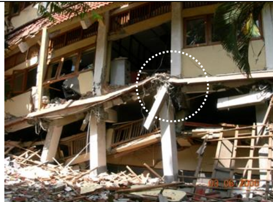
Gambar 13b Lemahnya tingkat bawah juga akibat lemahnya sambungan balok kolom, beam-column-joint . Join-kolom balok, terlihat tidak dilengkapi dengan sengkang penahan geser ( confined /shear stirrups ), akibatnya join mengalami kerusakan dini.
