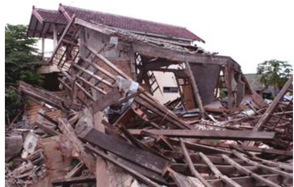
Gambar 7b Runtuh struktur rangka beton (BTRS), akibat kelemahan pada joint (BCJ, Beam Column Joints ), diikuti dgn jatuhnya seluruh rangka atap.
