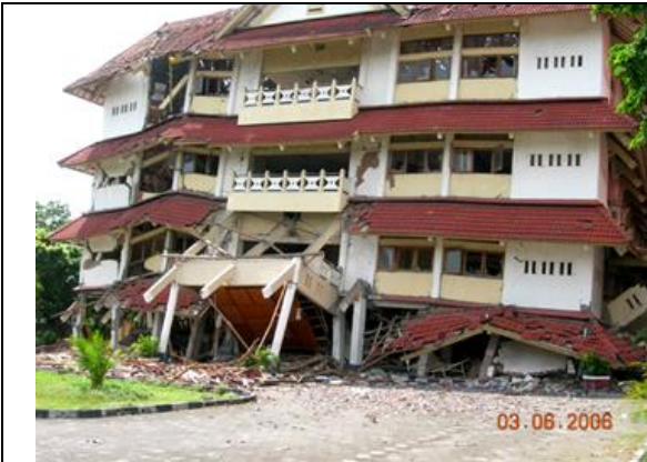
Gambar 13a Runtuh struktur terbawah, akibat lemahnya kolom-kolom di tingkat bawah ( soft story effect ). Tingkat terbawah terbuka, sedangkan tingkat di atasnya lebih kaku, dipasang banyak dinding pasangan bata.
