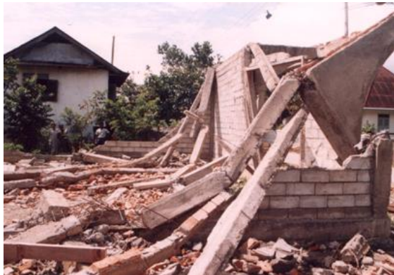
Gambar 7a Gempa Kerinci, Sumatera 7-10-1995, Struktur rangka beton bertulang yang dikombinasikan dengan dinding pasangan bata pengisi ( infill-wall ).
