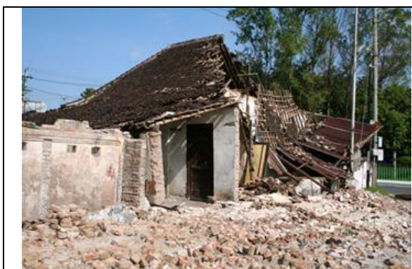
Gambar 5e Dinding bata polos roboh, diikuti jatuhnya rangka atap. Bata reruntuhan dinding berserakan akibat rendahnya mutu adukan, (latar depan). Gempa Yogya, Kab. Bantul.
