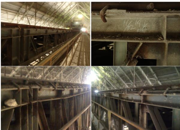
Gambar 1 Kerusakan pada struktur girder .
