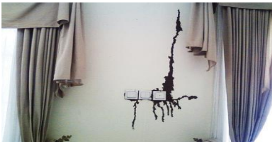
Gambar 15 Serangan rayap yang bersarang di belakang kotak kontak.
